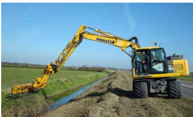
Un excavateur avec le panier faucardeur fixé au prolongateur pour une plus grande portée.
